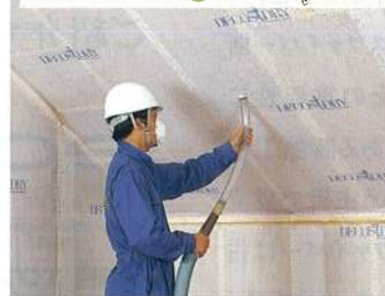
通気層を確保し屋根垂木に 施工密度 55±5 kg/m 3 でフローイング
